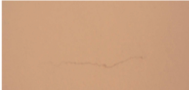
①合板ジョイントの割れ
