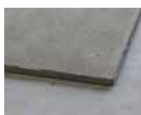
ガラス繊維の露出部分
